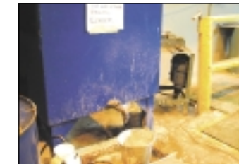
Lekkasjer fører til tap
