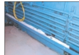
Lekkasje i maskin
