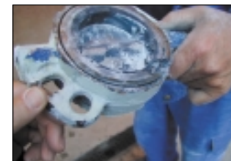
Slitasjeproblemer på ventil
