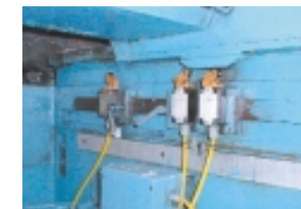
Sjekking av endebrytere
